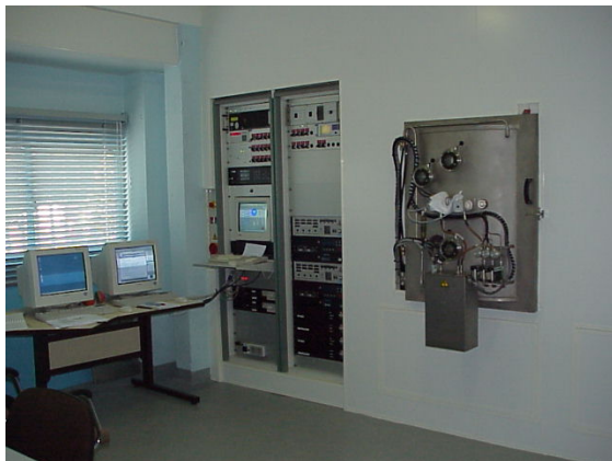
Photo 1a – Bâti DIBS, Armoires de Contrôle et Système de Pilotage
